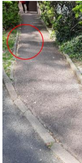
Reprise de revêtement craquelé
