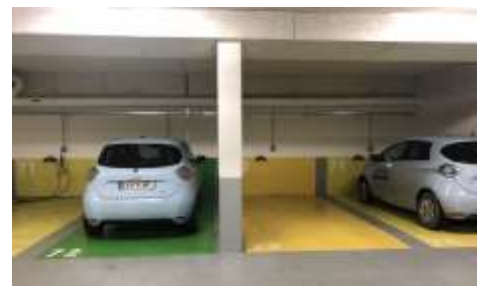
Parking Colombe : bornes de rechargement dédiées aux véhicules de service
